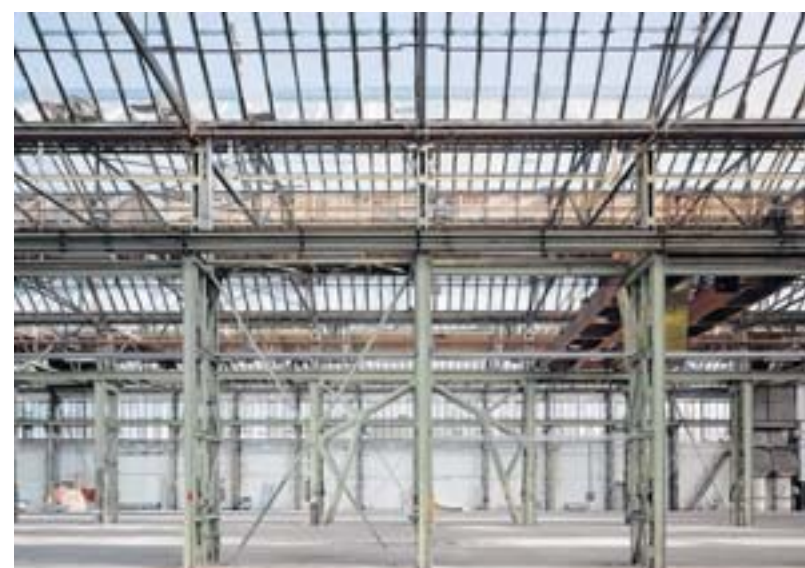
Eine der Hallen des Reisholzer Gewerbehöfes: Dort sollen in historischem Ambiente Arbeitsplätze oder Showrooms geschaffen werden. FOTO: MICHAEL REISCH
